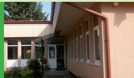
Csapadékvíz-elvezetés és villámvédelem a Zrínyi utcai óvodában
